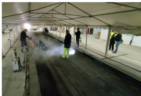
Instalação dos sensores
