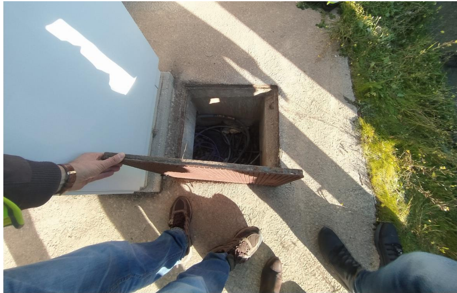
Caixa de visita junto ao bastidor
