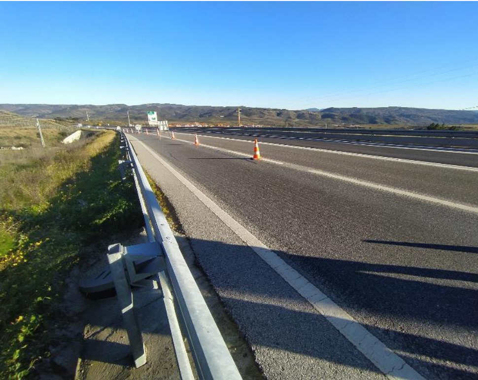
Caixa de visita junto aos sensores
